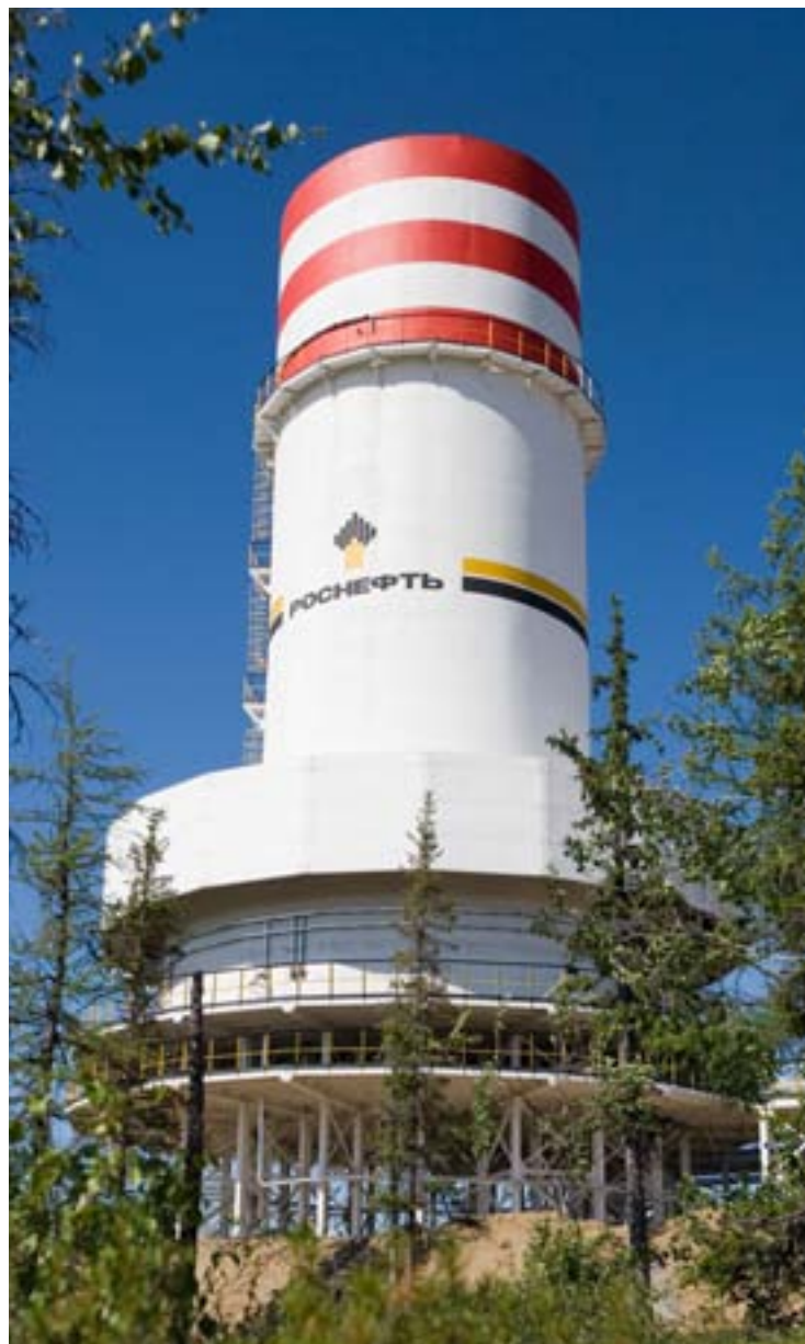
Установка бездымной утилизации (сжигания) попутного нефтяного газа
